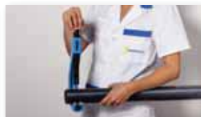
Cortar el tubo con los tronzadores.
